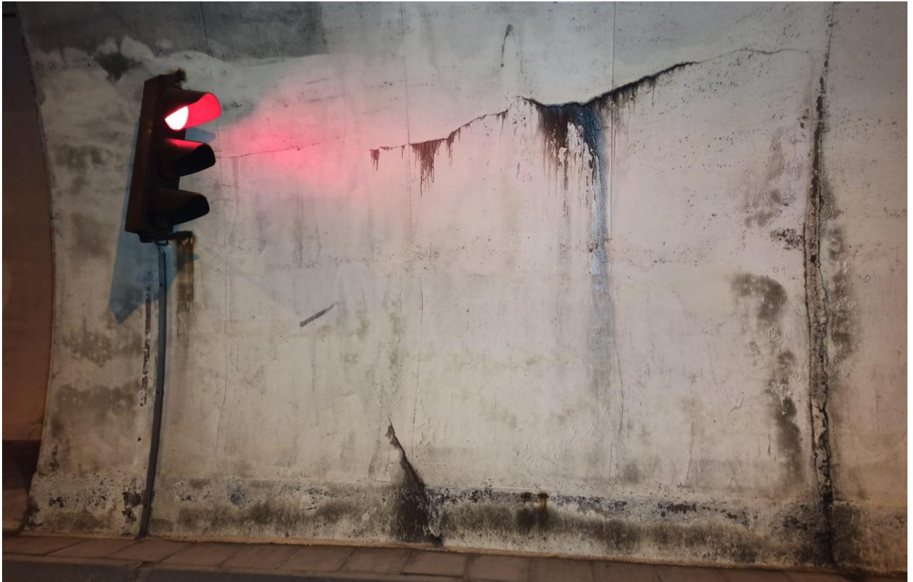
Slika 37: Kampada 91 - PUKOTINA, VLAŽENJE/ IZLUŽIVANJE
