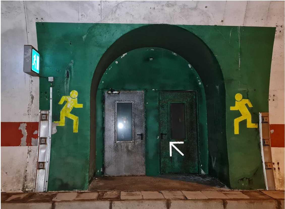
Slika 53: Kampada 151 - PUKOTINE, VLAŽENJE I LJUŠTENJE PREMAZA
