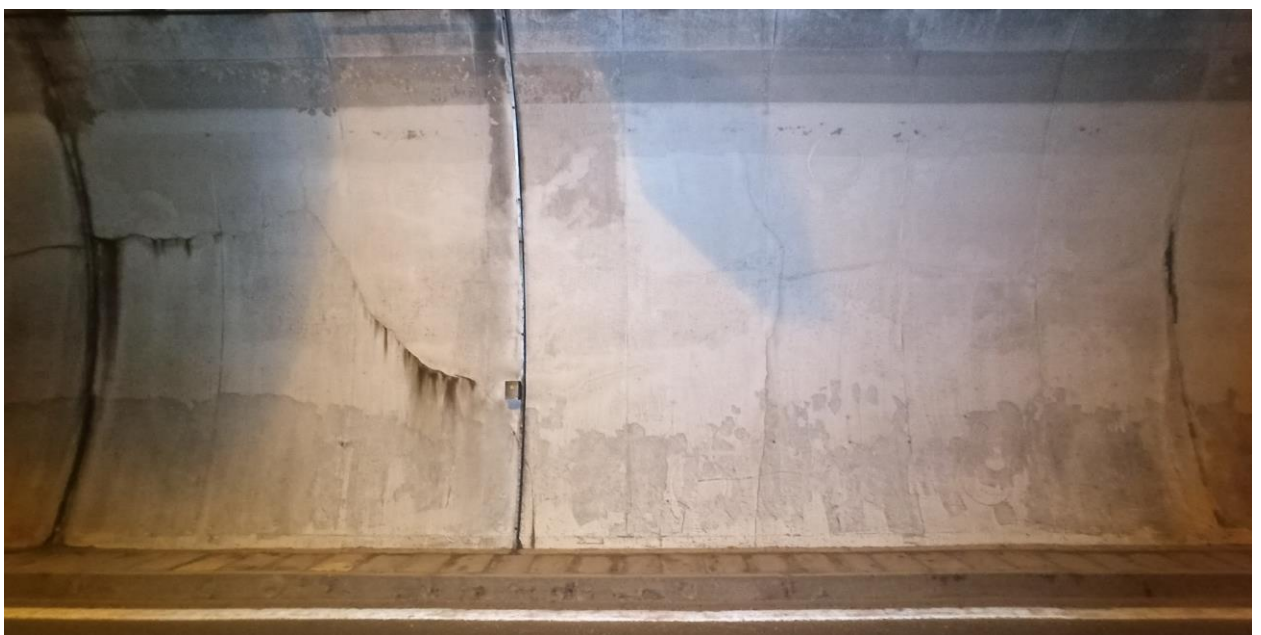
Slika 15: Kampada 18 - PUKOTINE I VLAŽENJE
