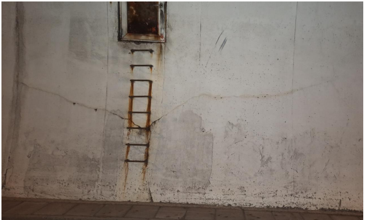
Slika 13: Kampada 9 - PUKOTINE I VLAŽENJE
