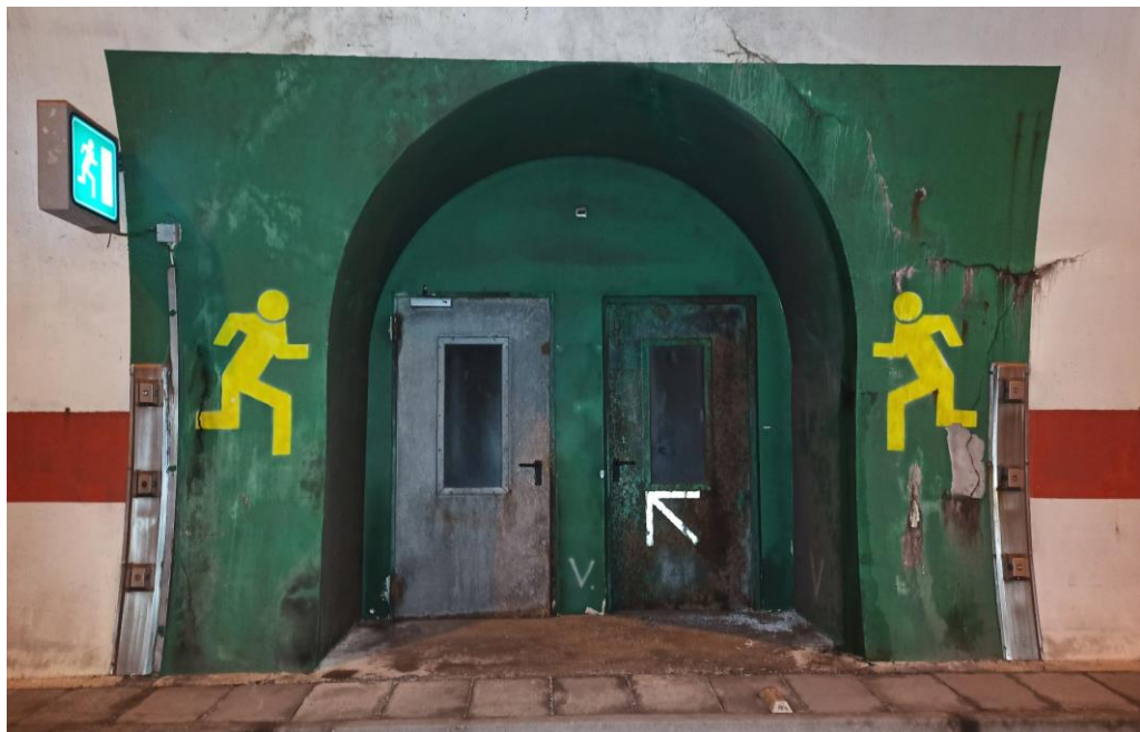
Slika 23: Kampada 57 - PUKOTINE, LJUŠTENJE BETONA I PREMAZA, LUŽENJE
