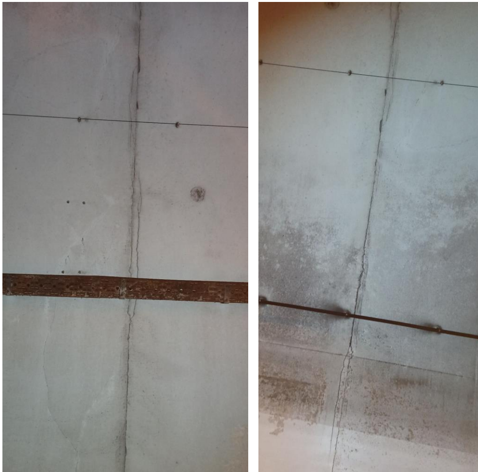
Slika 29: Kampada 66 - PUKOTINE NA SPOJNICI
