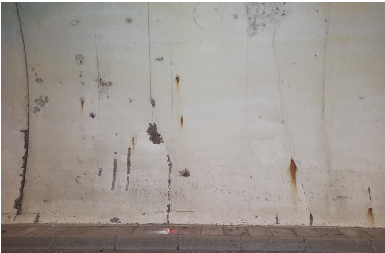
Slika 7: Kampada 3 - PUKOTINE, LJUŠTENJE PREMAZA I MRLJE OD KOROZIJE
