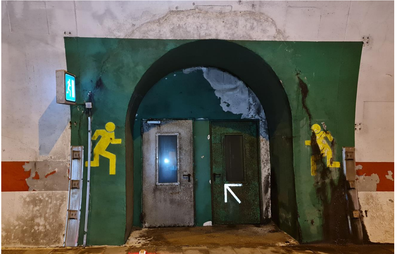
Slika 64: Kampada 197 - PUKOTINE, IZLUŽIVANJE I LJUŠTENJE PREMAZA
