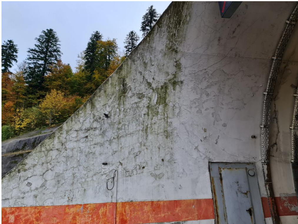
Slika 3: Ulazni portal - PUKOTINE, LJUŠTENJE PREMAZA
