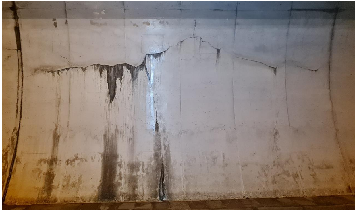
Slika 62: Kampada 188 - PUKOTINA, IZLUŽIVANJE
