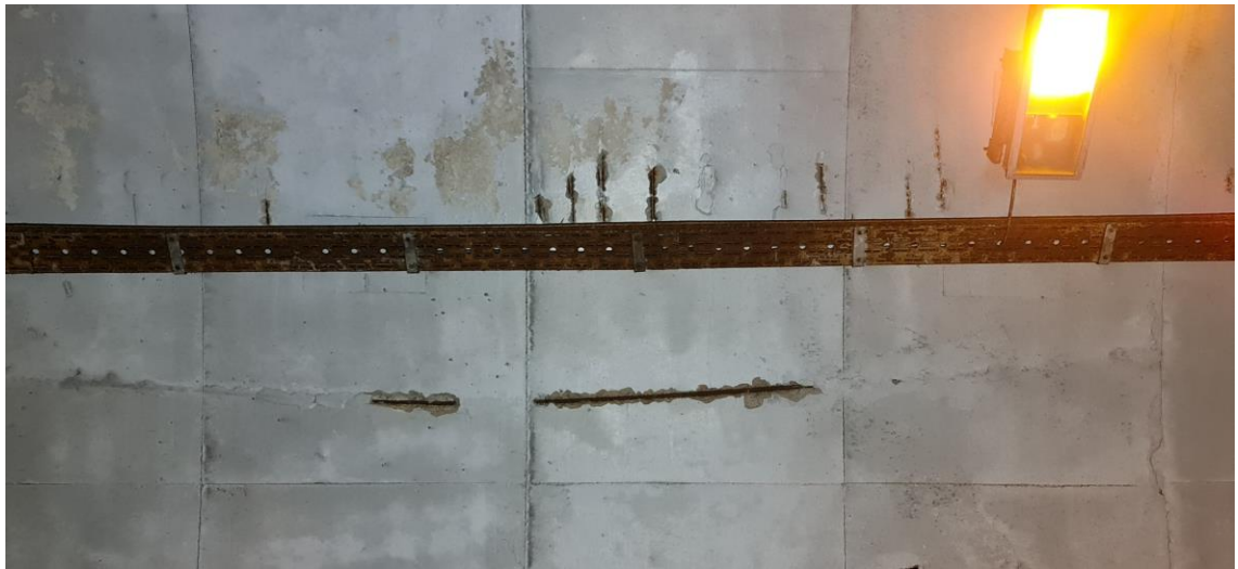
Slika 39: Kampada 97 - LJUŠTENJE BETONA I ARMATURA BEZ ZAŠTITNOG SLOJA
