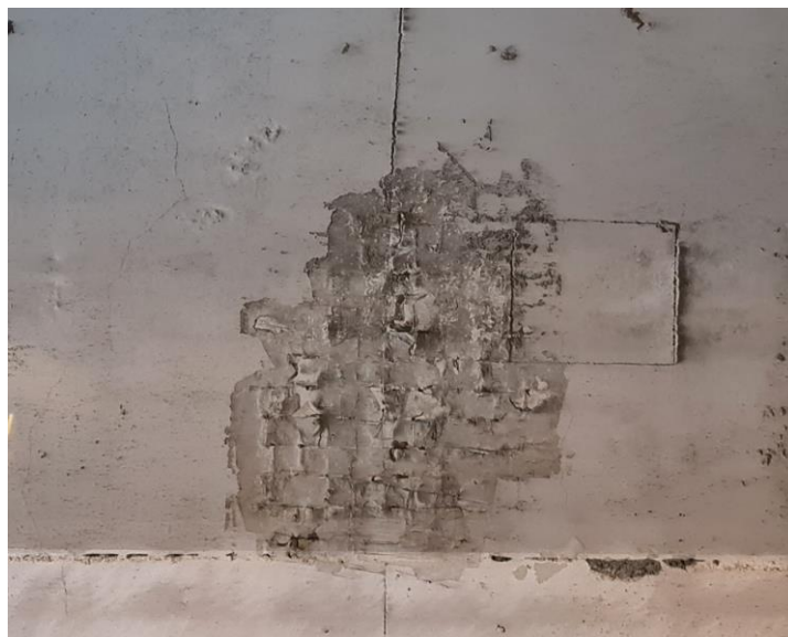
Slika 56: Kampada 164 - ARMATURA BEZ ZAŠITNOG SLOJA I LJUŠTENJE BETONA
