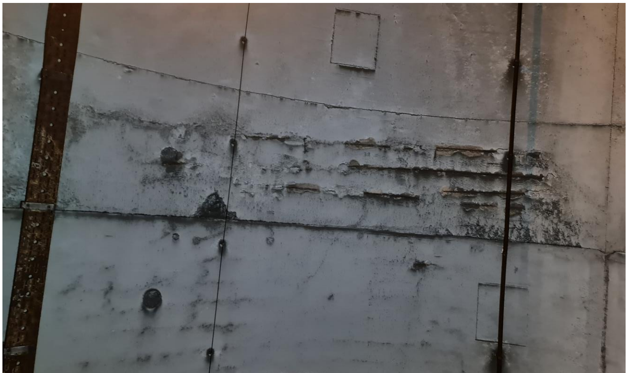
Slika 49: Kampada 134 - ARMATURA BEZ ZAŠITNOG SLOJA I LJUŠTENJE BETONA
