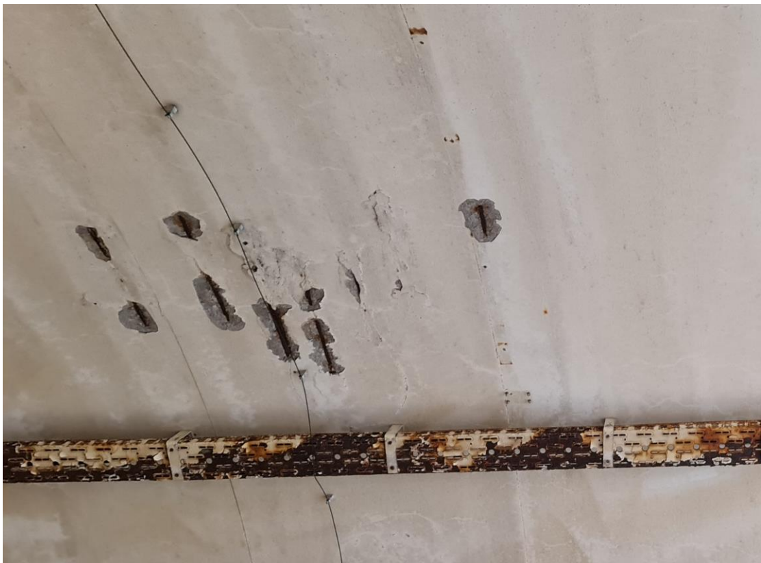
Slika 4: Kampada 2 - ARMATURA, ODLAMANJE BETONA
