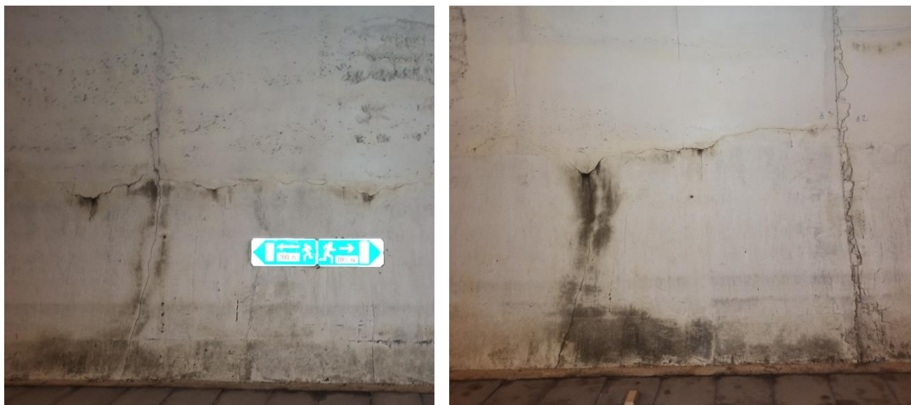
Slika 35: Kampada 83 - PUKOTINE, IZLUŽIVANJE
