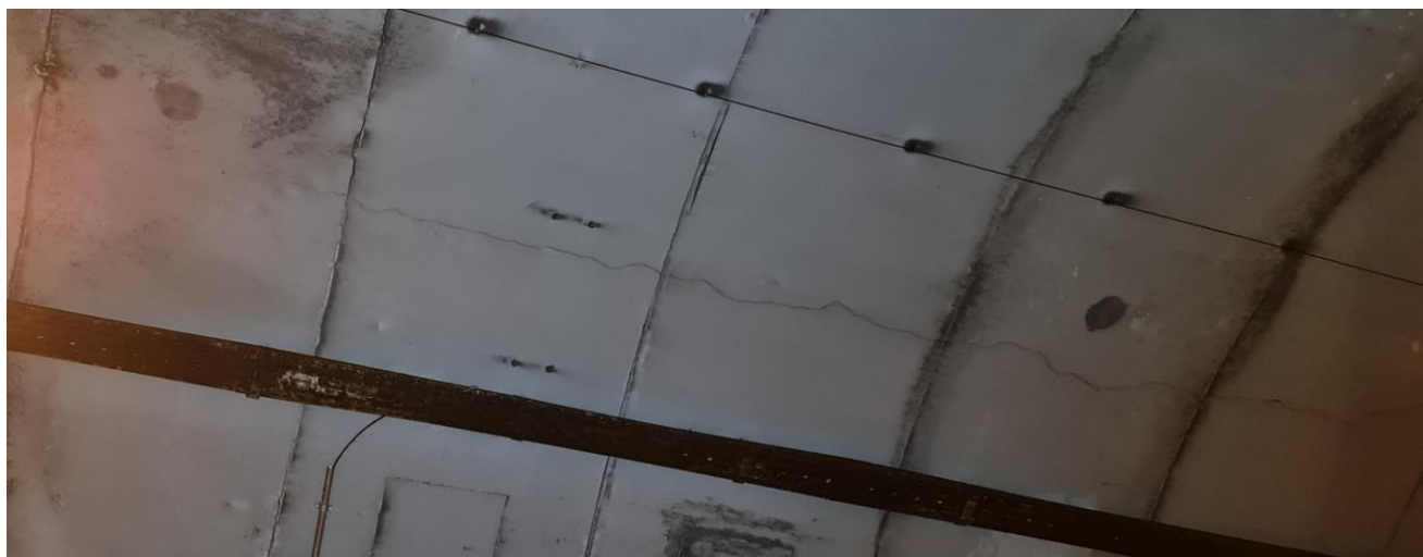
Slika 59: Kampada 172 - PUKOTINA, IZLUŽIVANJE I LJUŠTENJE PREMAZA I BETONA
