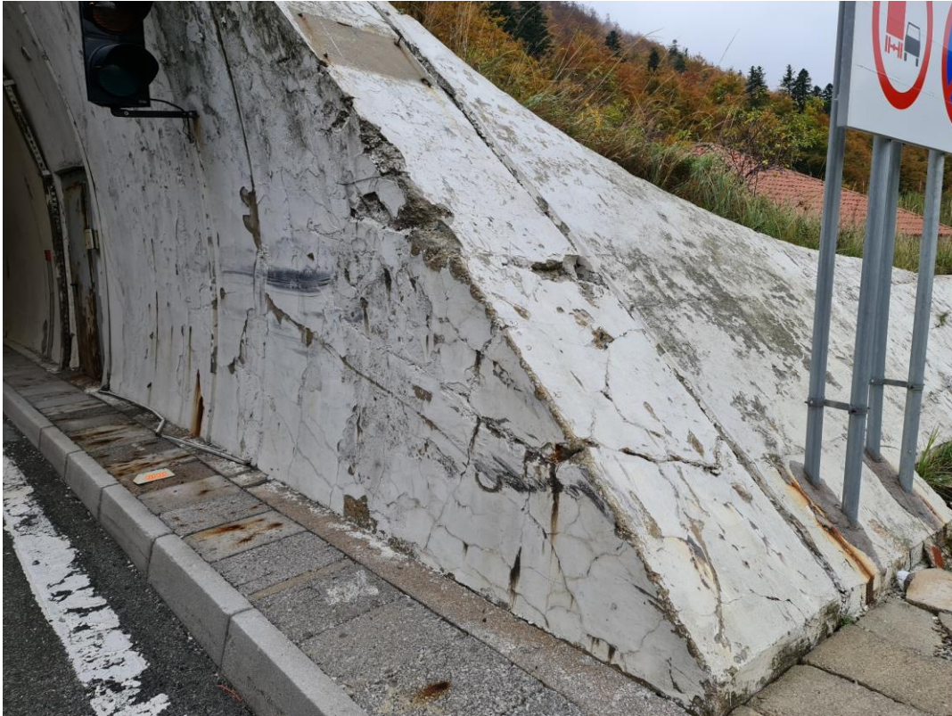
Slika 1: Ulazni portal - LJUŠTENJE BETONA, PUKOTINE
