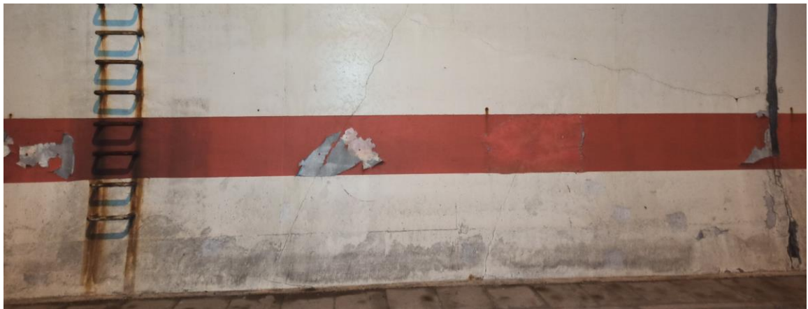
Slika 9: Kampada KOROZIJA I LJUŠTENJE PREMAZA 5
