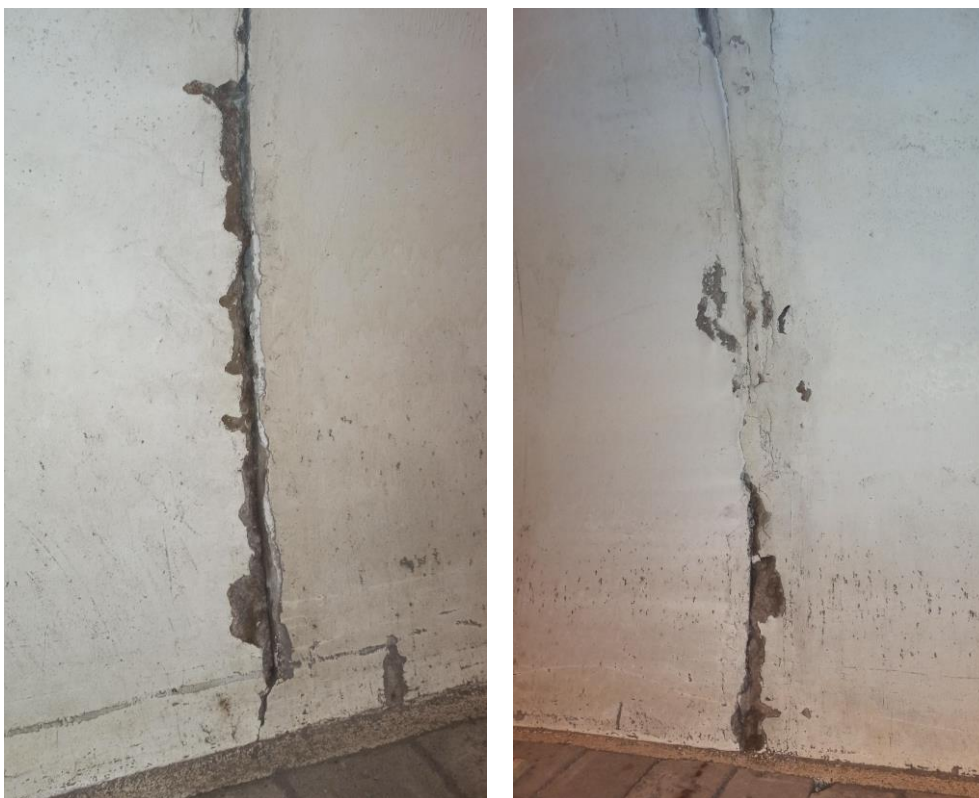
Slika 8: Kampada 4 - LJUŠTENJE I ODLAMANJE BETONA NA SPOJNICI
