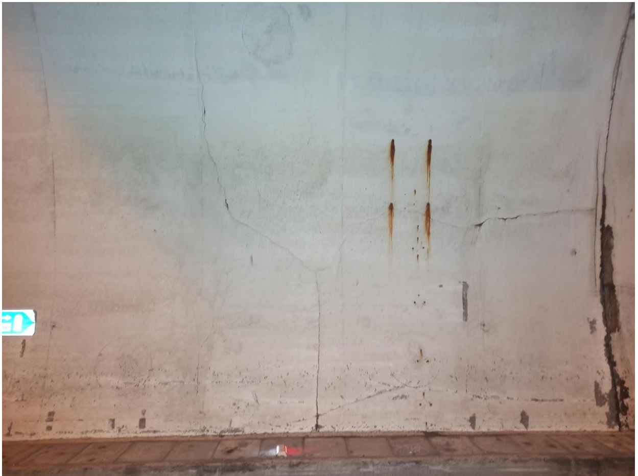
Slika 11: Kampada 6 - KOROZIJA I PUKOTINE
