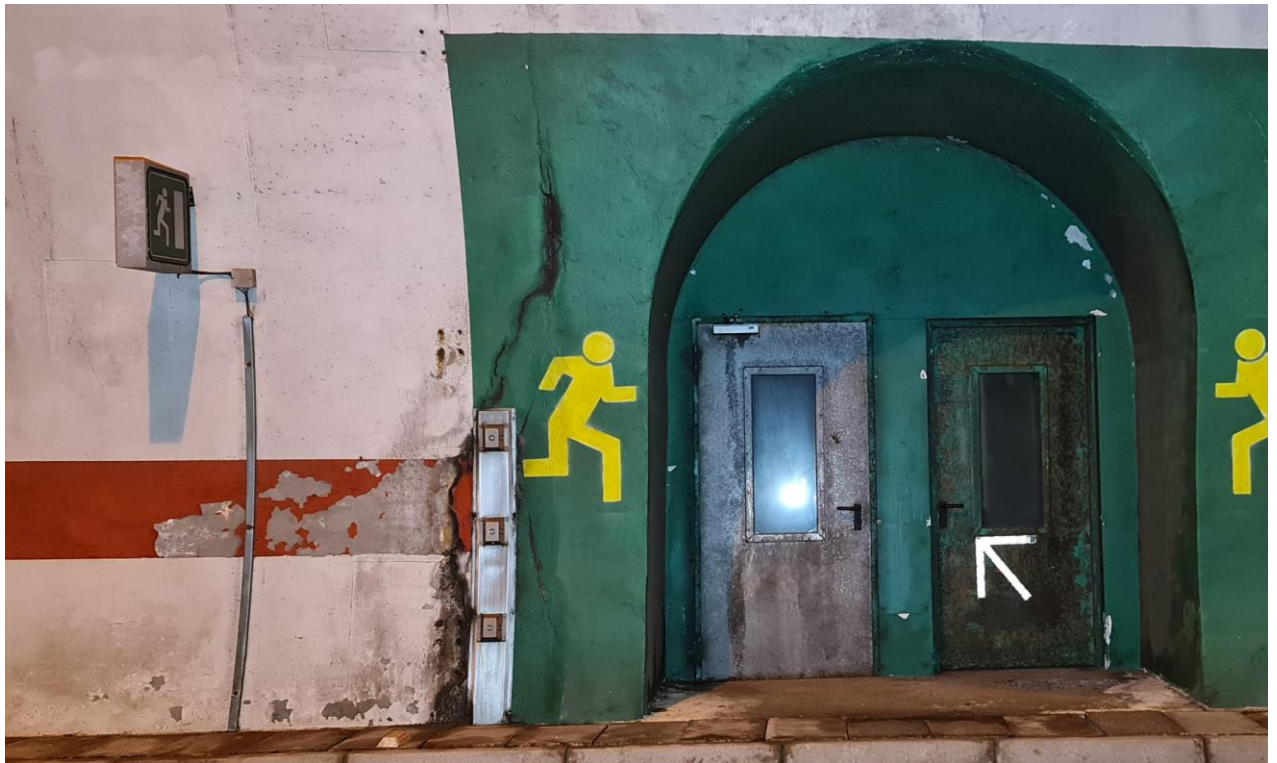
Slika 46: Kampada 130 - PUKOTINA, VLAŽENJE/ IZLUŽIVANJE I LJUŠTENJE PREMAZA
