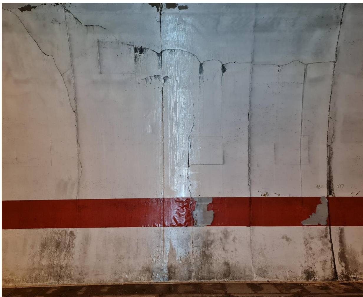
Slika 60: Kampada 186 - PUKOTINA, IZLUŽIVANJE I LJUŠTENJE PREMAZA
