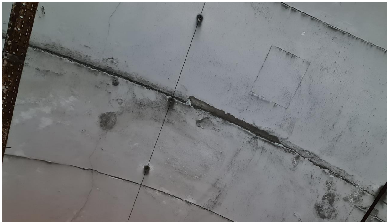
Slika 58: Kampada 167-168 - PUKOTINA, ODLAMANJE BETONA
