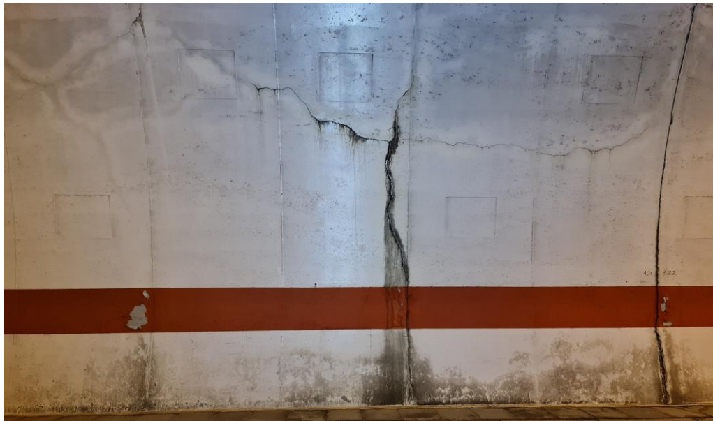
Slika 43: Kampada 121 - PUKOTINA I IZLUŽIVANJE
