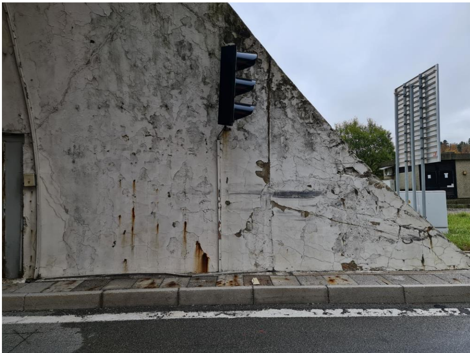
Slika 2: Ulazni portal - LJUŠTENJE BETONA, PUKOTINE I KOROZIJA
