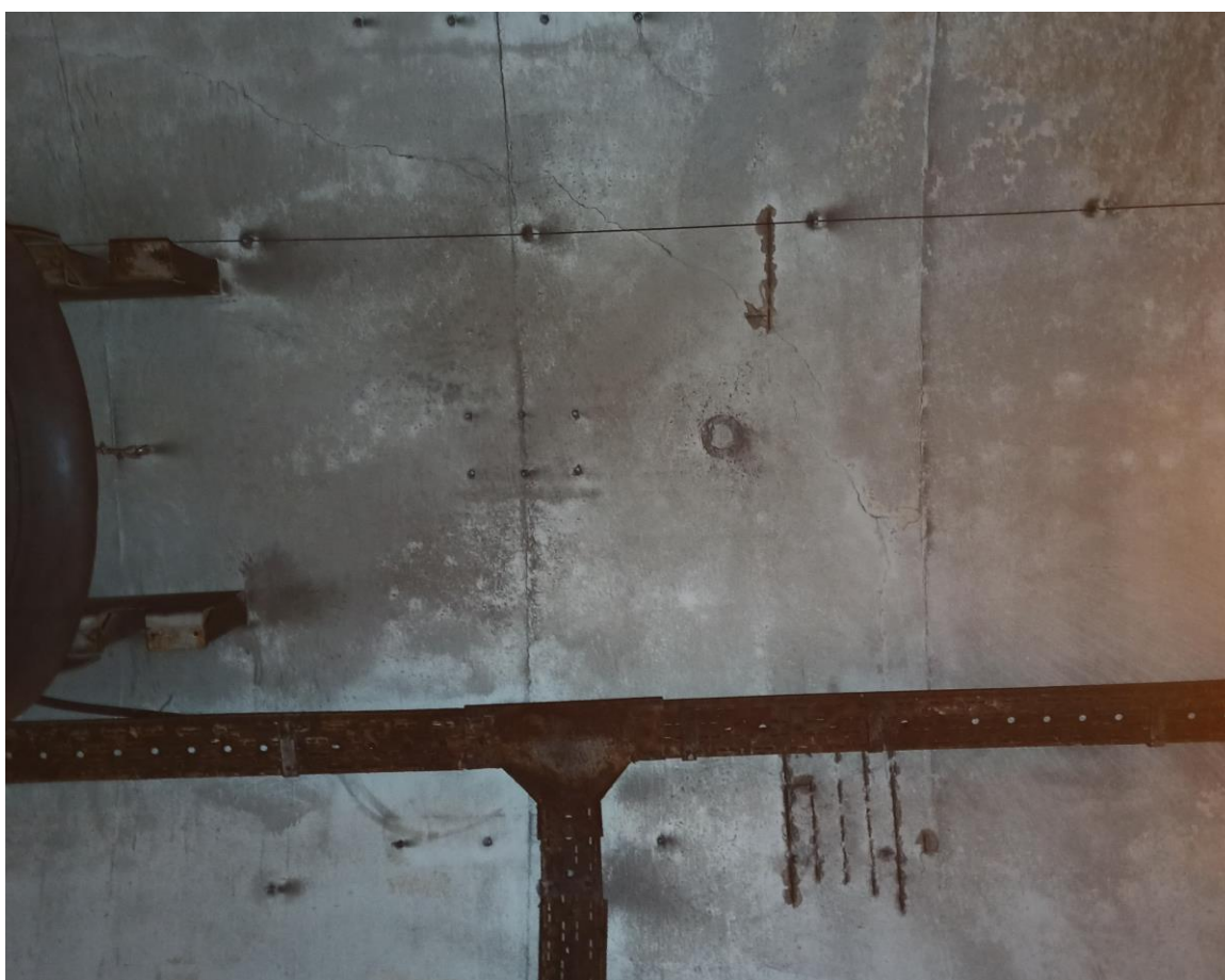
Slika 36: Kampada 90 - PUKOTINA, IZLOŽENA ARMATURA I LJUŠTENJE BETONA
