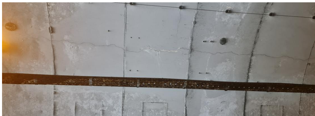
Slika 50: Kampada 140 - PUKOTINA, LJUŠTENJE PREMAZA
