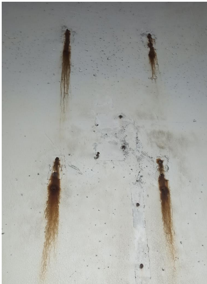
Slika 32: Kampada 73 - MRLJE OD KOROZIJE
