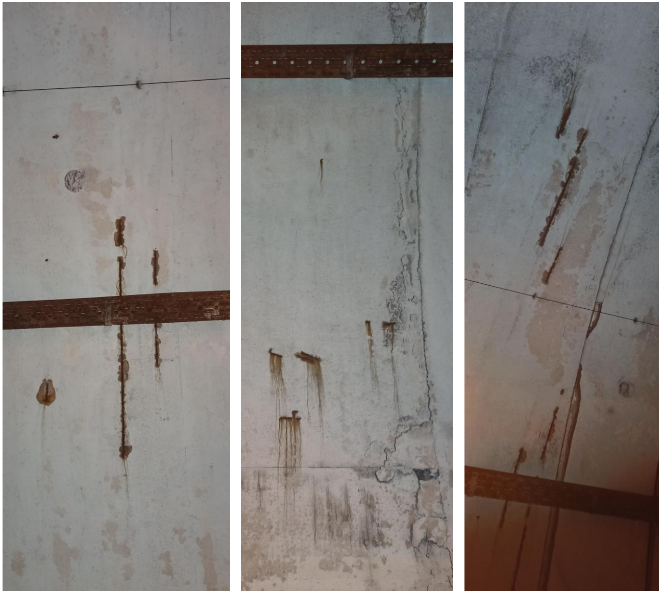
Slika 21: Kampada 45 - KOROZIJA, IZLOŽENA ARMATURA I ODLAMANJE BETONA
