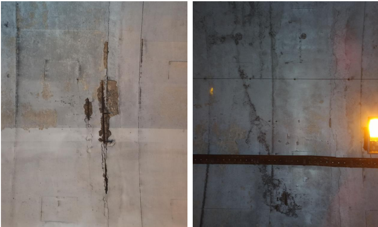
Slika 38: Kampada 92 - PUKOTINA, ODLAMANJE BETONA, IZLOŽENA ARMATURA I SEGREGACIJA
