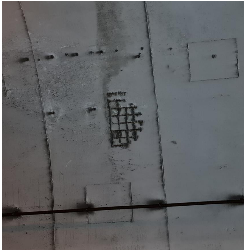
Slika 54: Kampada 153 - ARMATURA BEZ ZAŠITNOG SLOJA I LJUŠTENJE BETONA
