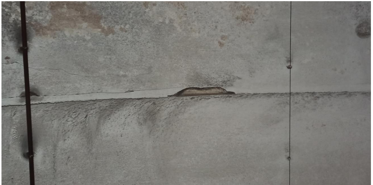
Slika 18: Kampada 35 - ODLAMANJE BETONA
