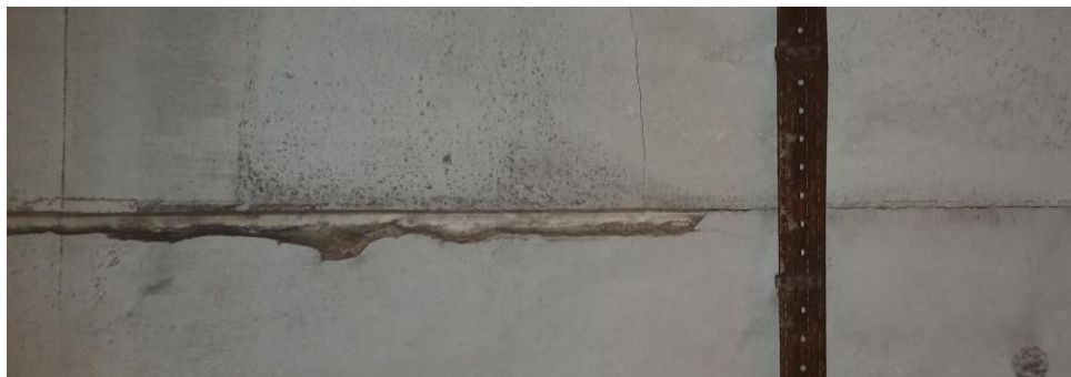
Slika 34: Kampada 78-79 - LJUŠTENJE BETONA NA SPOJNICI
