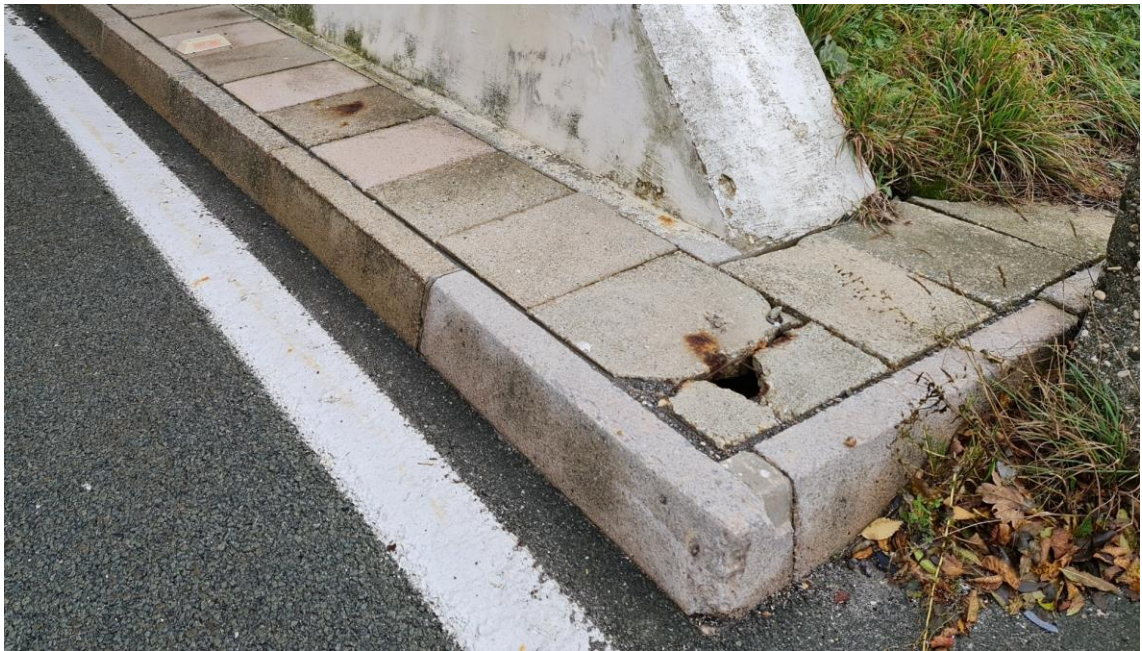
Slika 67: Izlazni portal - ODLAMANJE BETONSKE PLOČE HODNIKA
