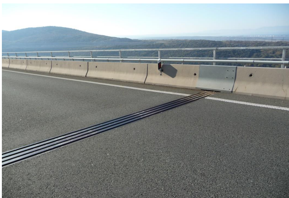
Slika 1.2-2 Pogled na zapadnu prijelaznu napravu (smjer Rijeka)
