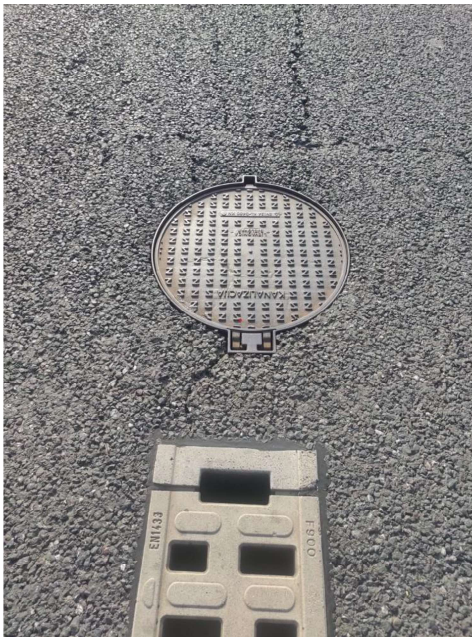
Slika 5. Oštećeni poklopac i okvir revizijskog okna RO_2 i asfalt oko okna između staza 10 i 11 ( ulazna strana NP Zagreb istok_smjer Lipovac )
