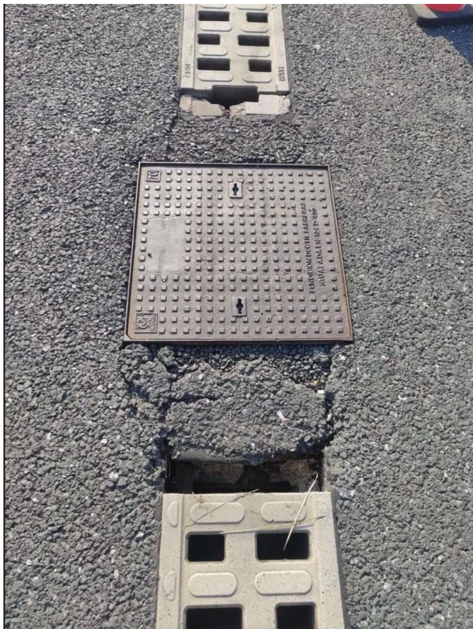
Slika 2. Oštećeni okvir revizijskog okna RO_15, čeonu stijenke kanala linijske odvodnje i asfalt oko okna između staza 4 i 5 ( izlazna strana NP Zagreb istok_smjer Bregana )
