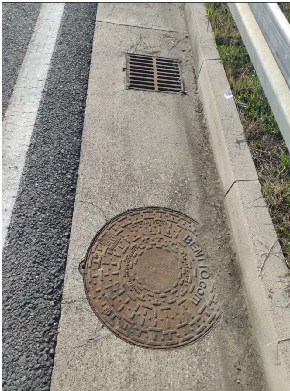
Slika 6. Revizijsko okno u rigolu uz rub kolnika NP
