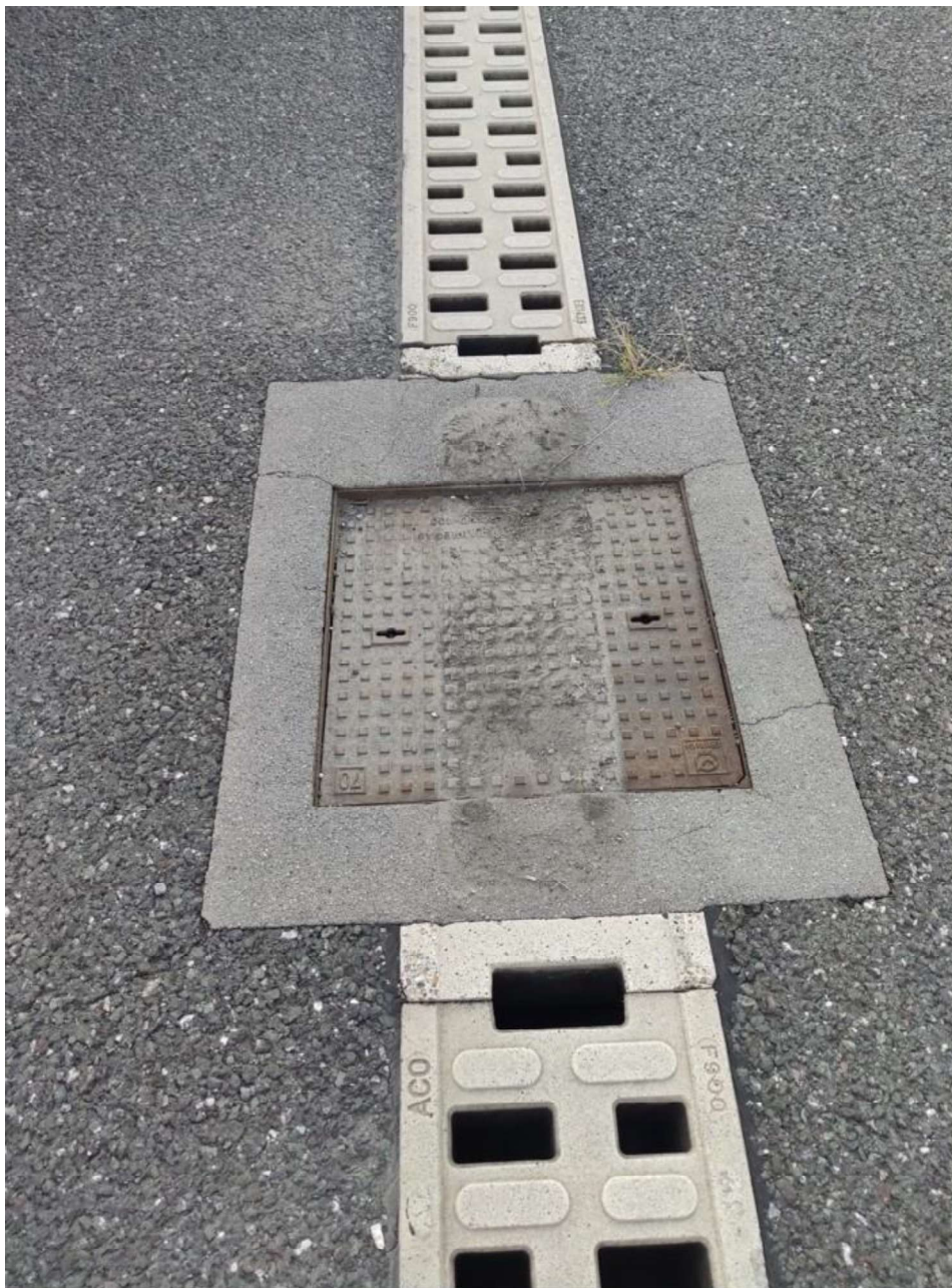
Slika 1. Oštećeni poklopac i okvir revizijskog okna RO_16 na kanalu linijske odvodnje između staza 4 i 5 ( izlazna strana NP Zagreb istok_smjer Bregana )
