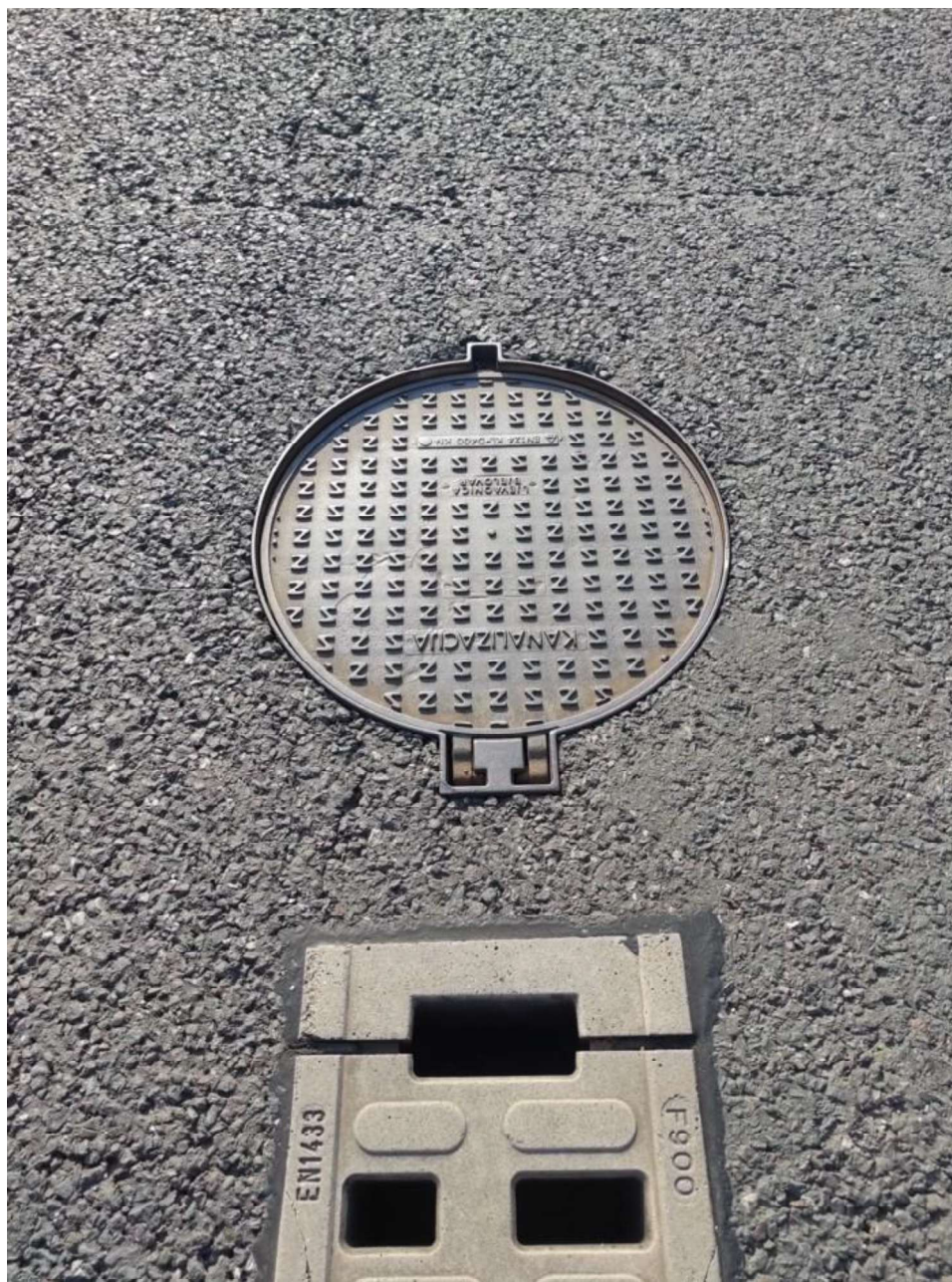
Slika 4. Oštećeni poklopac i okvir revizijskog okna RO_4 između staza 4 i 5 ( ulazna strana NP Zagreb istok_smjer Bregana )
