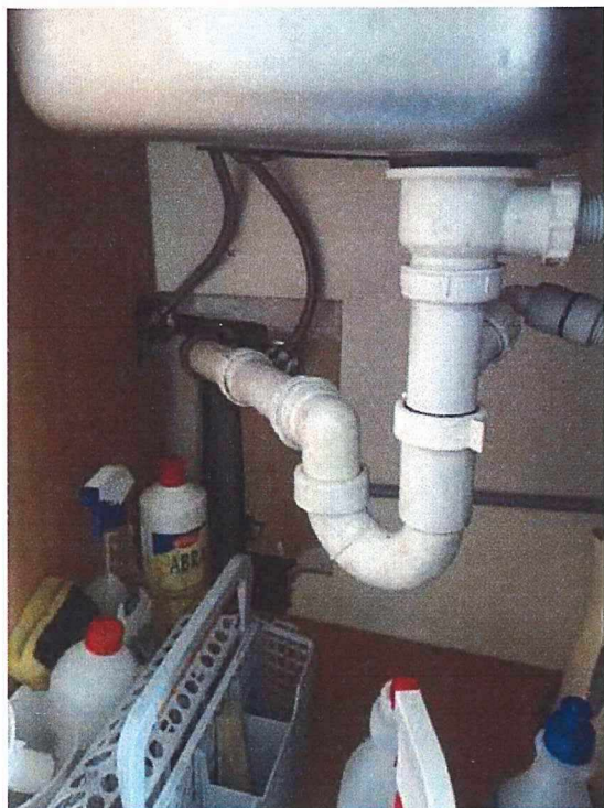
Odvod sudopera u čajnoj kuhinji na 6. katu
