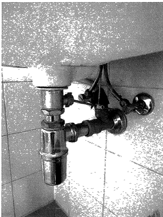
Sifon umivaonika na 6. katu sa priključkom za odvod kondenzata klima uređaja
