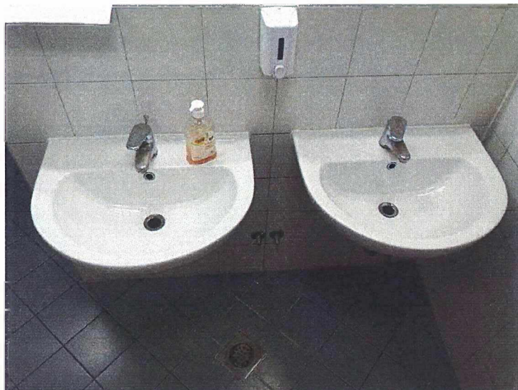
Primjeri umivaonika na kojima nedostaju poklopci odvoda
