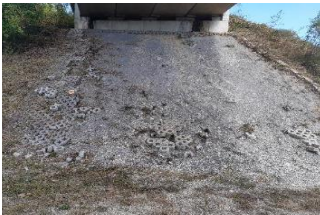
POSTOJEĆE STANJE POKOSA UPORNIJAKA NADVOŽNJAKA BOBOVICA U km 2+326 - LIJEVO
