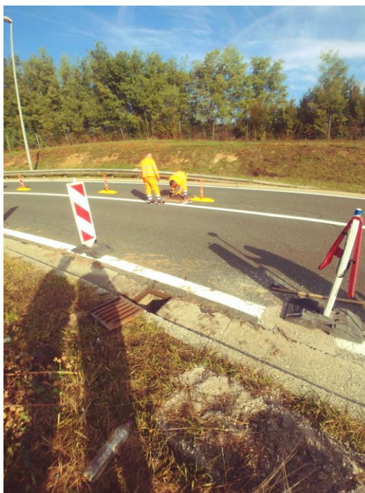
Slika 2. Pogled na postojeći slivnik SL_2, zatranu rupu u blizini slivnika i revizijsko okno RO_2
