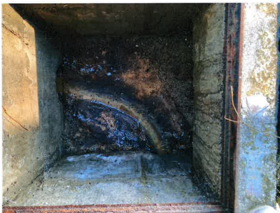
1. Karakteristično revizijsko okno sanitarne odvodnje RO_F1
