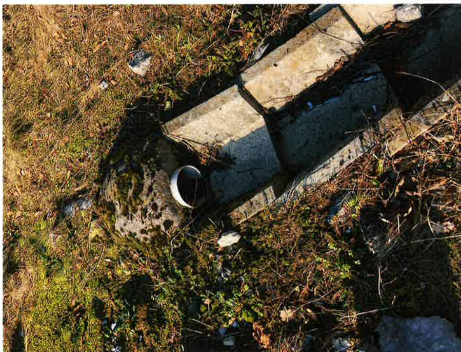
Slika 3. Ispust u teren iz biorotora (ispust_1)
