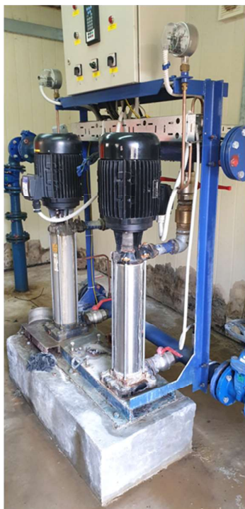
Slika 1. Postojeća hidrostanica za podizanje tlaka
